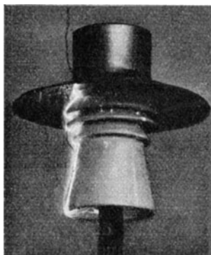
Abb. 60. Gleitende Entladungen an einem Isolator mit Metalldach.
