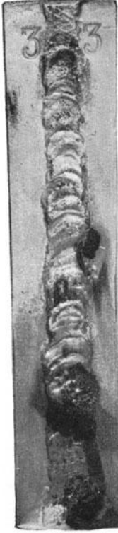
Abb. 33. Autogen geschweißtes Versuchsblech aus V4A-Stahl nach Behandlung mit Hypochlorit-Bleichlauge. Die Korrosionen sind über die ganze rauhe Schweißnaht verteilt.
