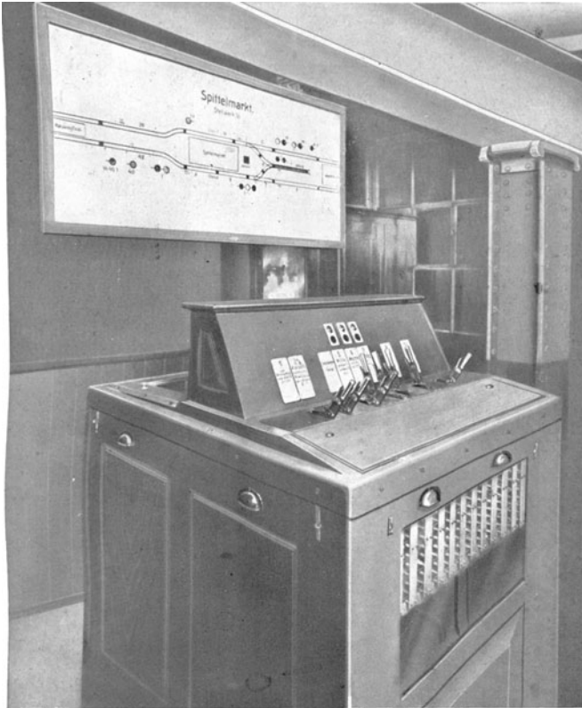
Abb. 188. Neues Stellwerk des Bahnhofs Spittelmarkt (Bauart Westinghouse).
