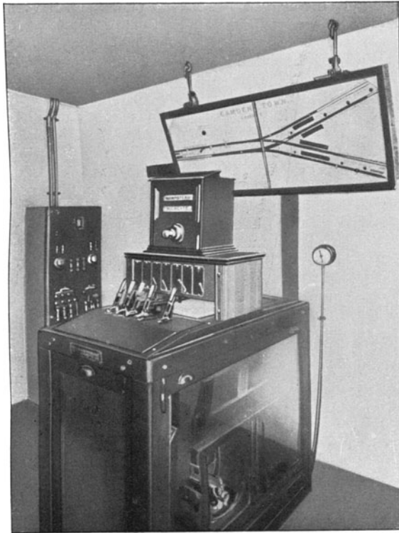
Abb. 24. Stellwerk Camden Town mit Fahrtafel. (Charing Croß-, Euston- und Hampstead-Bahn.)
