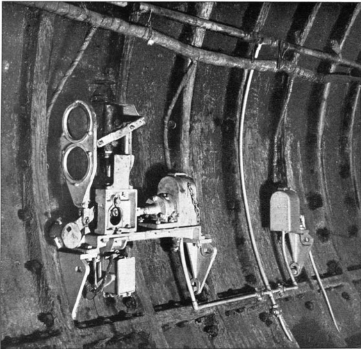
Abb. 12. Röhrenbahnsignal mit Druckluftantrieb; rechts das Fahrsperrventil.
