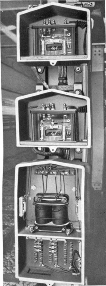
Abb. 95. Befestigungsweise der Linienrelais und Transformatoren an einer Tunnelstütze.
