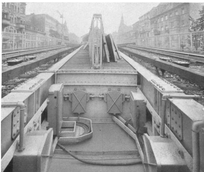
Abb. 96. Befestigungsweise der Relais und Transformatoren an Brückenträgern.
