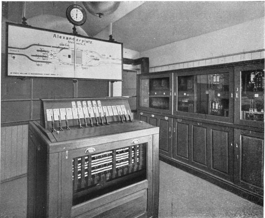
Abb. 160. Stellwerk im Bahnhof Alexanderplatz
