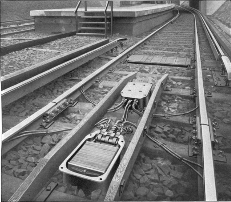
Abb. 89. Drosselstoß innerhalb eines Gleises der Berliner Untergrundbahn (Rechts und links die Schienentrennstöße.)
