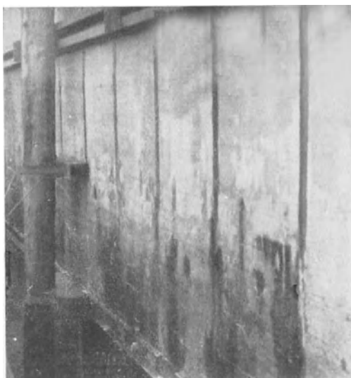
Abb. 35. Hafenmauer bei Ebbe, beschädigt durch Gipswasser, das sich aus Gipsverunreinigungen aus den zum Auffüllen verwendeten Erdmassen gebildet hat.
