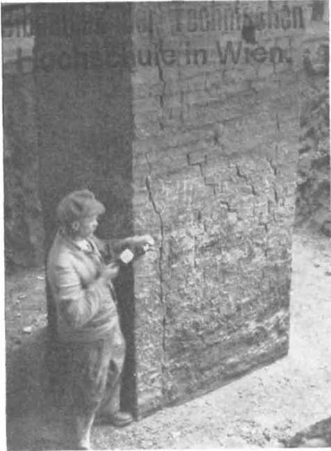
Abb. 21. Durch Einwirkung von Schwefelsäure zerstörter Pfeiler. (Aufn. Prof. Mohr, L'hafen.)
