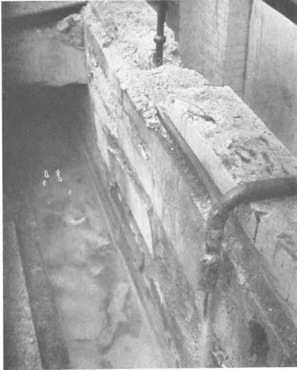
Abb. 30. Beton einer Abwasserrinne, durch Sulfate zerstört.
