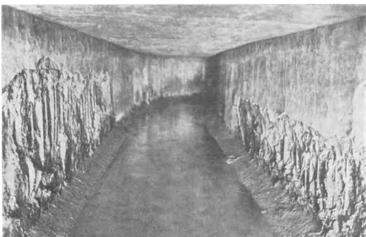
Abb. 25. Betonkanal, beschädigt durch Sulfatbildung im Beton.
