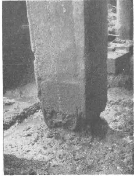
Abb. 51. Durch frühzeitige Überflutung mit salzhaltigem Grundwasser beschädigter Betonpfeiler.
