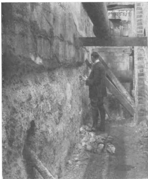
Abb. 28. Betonwand einer Abwasserrinne, durch Ammonsulfat zerstört.
