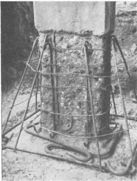
Abb. 52. Umschnürung des nach Abb. 51 beschädigten Pfeilers mit Bewehrungsseisen.
