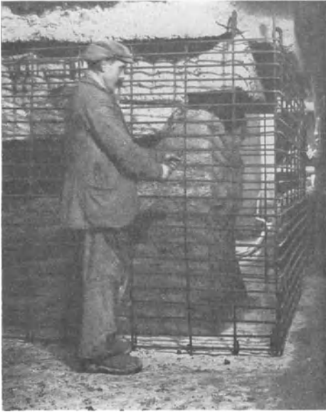
Abb. 50. Umgebung eines durch Salzwasserwirkung beschädigten Fundaments nach Entfernung der mürben Anteile mit einem Drahtgeflecht vor Aufbringung des neuen Hochfenzementbetons (Aufnahme Goebel, Ludwigshafen).
