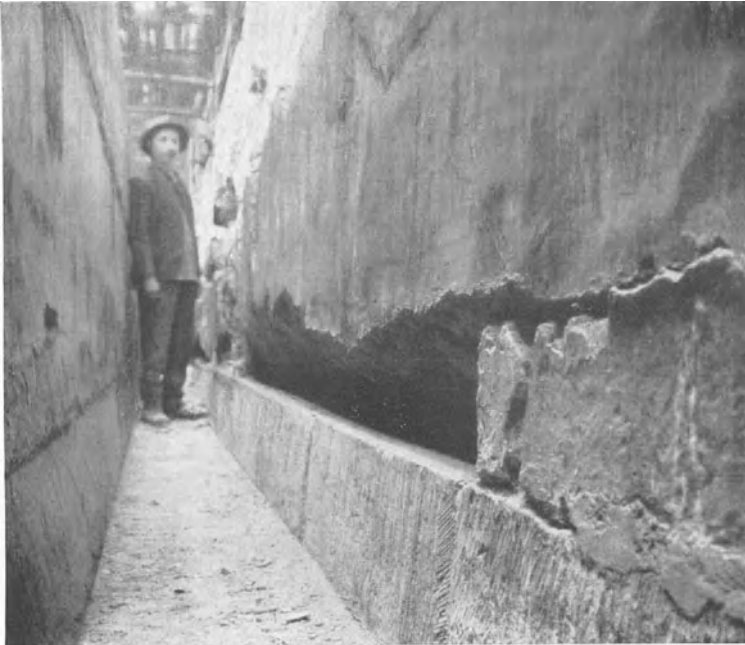
Abb. 29. Betonwand über einer Abwasserrinne aus Sandstein, durch ammonisulfathaltiges Wasser zerstört.
