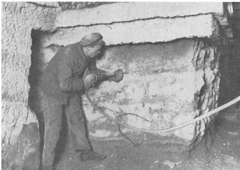
Abb. 49. Entfernung von durch Sulfatwirkung beschädigtem Beton durch Lufthammer bis tief in den Kern vor Aufbringung des neuen Betons. (Aufnahme Goebel, Ludwigshafen).
