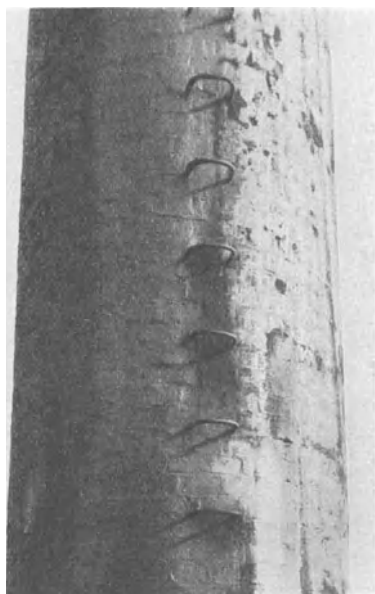
Abb. 23. Durch nitrose Gase beschädigter Schornstein. (Aufn. Prof. Mohr, L'hafen.)
