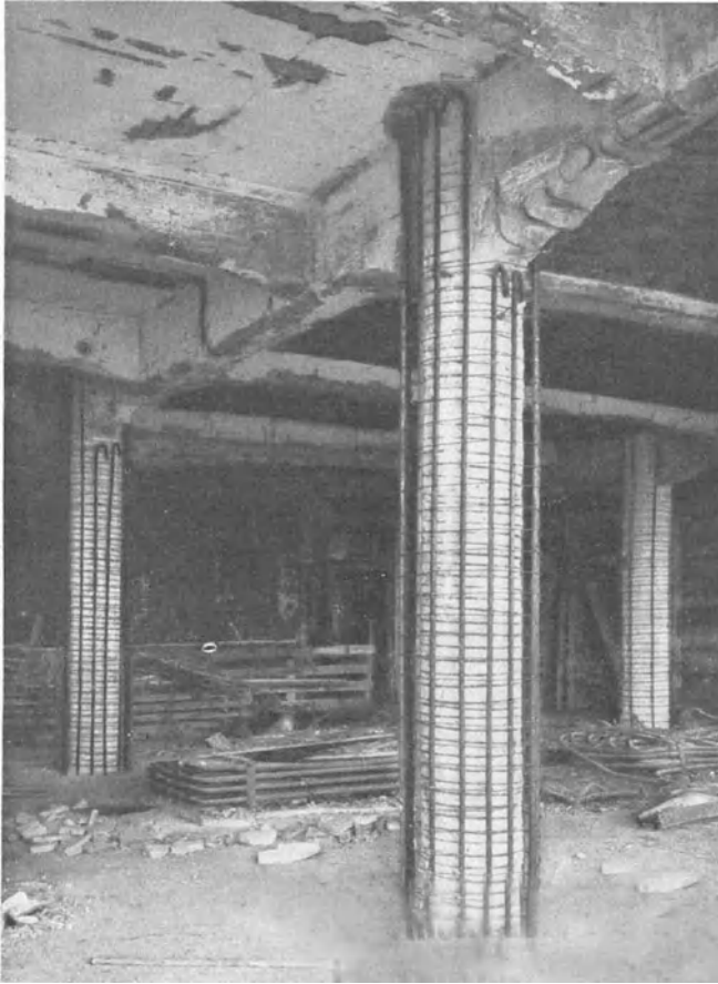
Abb. 43. Zerstörung durch Feuer in der Sarottifabrik. Die Säulen sind wieder mit Bewehrungsseisen zur Aufnahme des Spritzbetons umgeben. (Moser-Kraftbau.)
