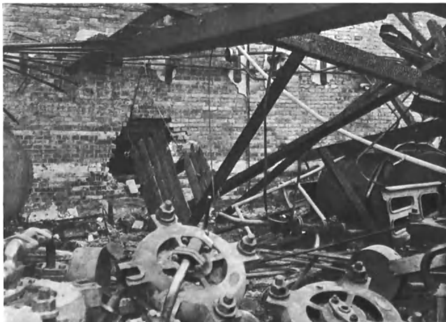
Abb. 27. Filteranlage nach der Explosion.
