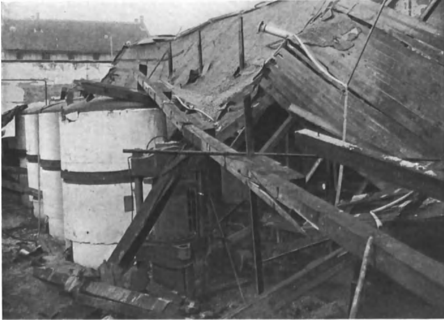
Abb. 26. Kollodiumherstellungsanlage nach der Explosion.
