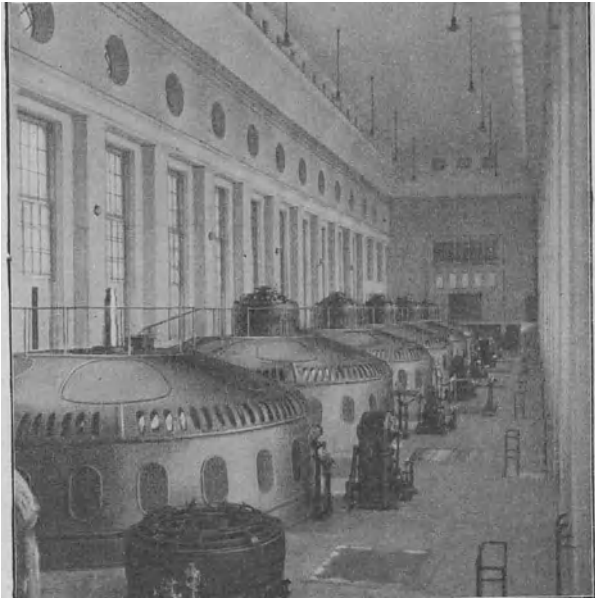
Abb. 182. Kraftwerk Eglisau. Kurz vor Fertigstellung. Hinten an der Decke drei Warmluftaustrittsöffnungen („A“ der Abb. 183).
