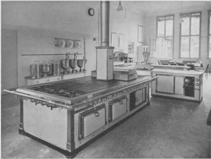
Abb. 4. Diätküche im Krankenhaus Hamburg-Eppendorf.
