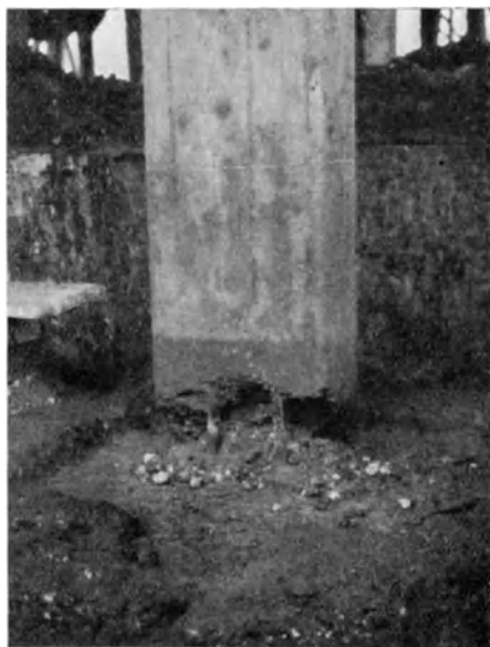
Abb. 18. Zerstörung eines Säulenfußes durch salzhaltiges Grundwasser. (Nach Grün, Beton.)
