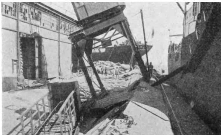
Abb. 223. Durch Erdbeben zerstörte Kaimauer in Yokohama.
