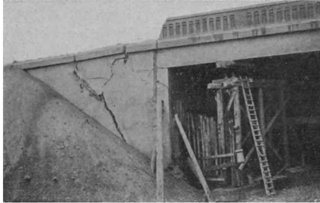
Abb. 2. Lichtbild der falsch gegründeten Unterführung.
