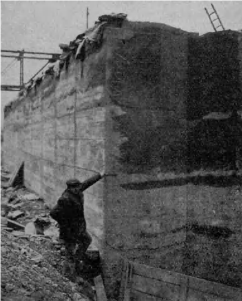
Abb. 21. Vorsatzbeton verschiedener Schichtdicke (Grenze zwischen Vorsatz- und Kernbeton nachgezeichnet).
