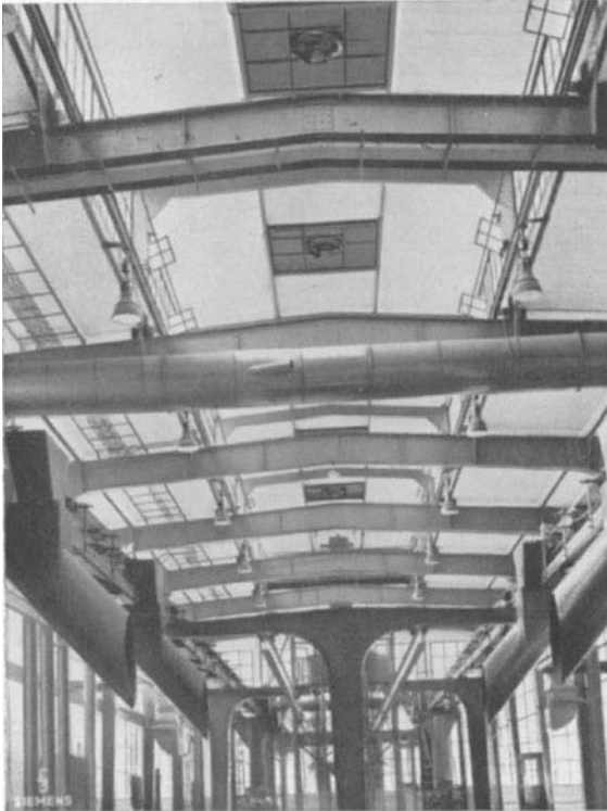
Abb. 85. Absaugende Ventilatoren in den Dachreitern.
