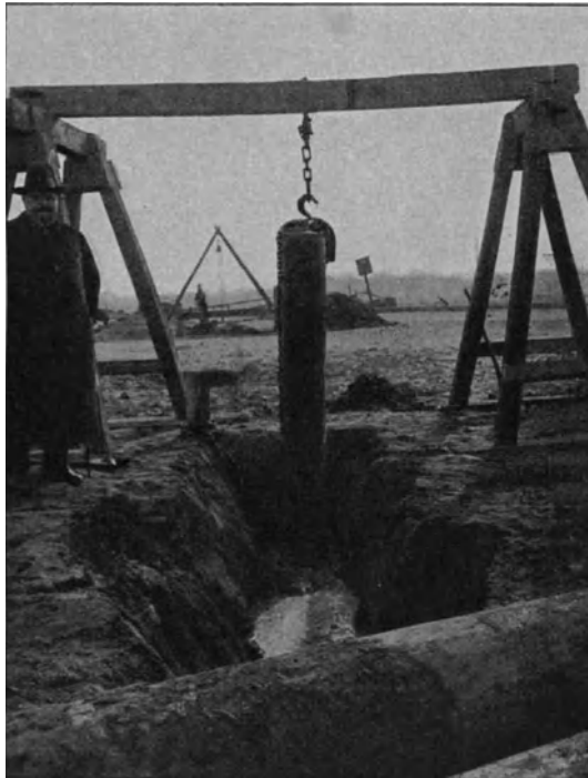
Fig. 15. Gegen Moorsäure isolierter Betonpfahl „Mast“ am Osthafen zu Berlin.
