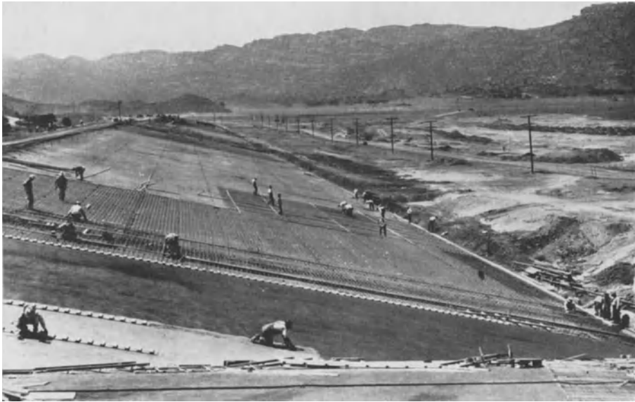
Abb. 342. Böschungsbefestigung (gegen Wellenschlag) in Eisenbeton auf gewalztem selbst-dichtem Erddamm. Chatsworth Nr. 2. (Aufnahme von Proctor, Los Angeles.)
