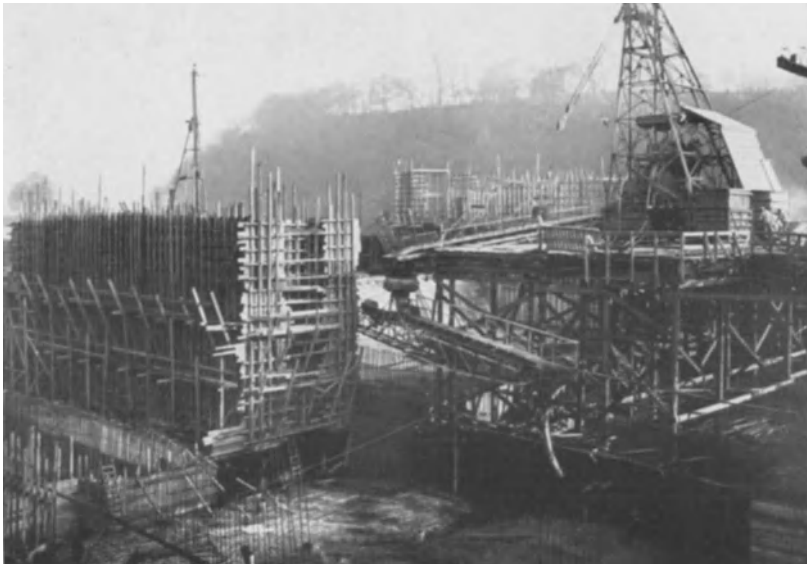
Abb. 1041. Fahrbare Förderbandanlage Ruhrwehr Baldeney.
