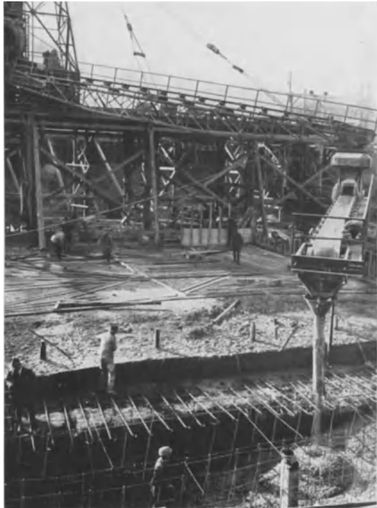
Abb. 1042. Fahrbare Förderbandanlage Ruhrwehr Baldeney.
