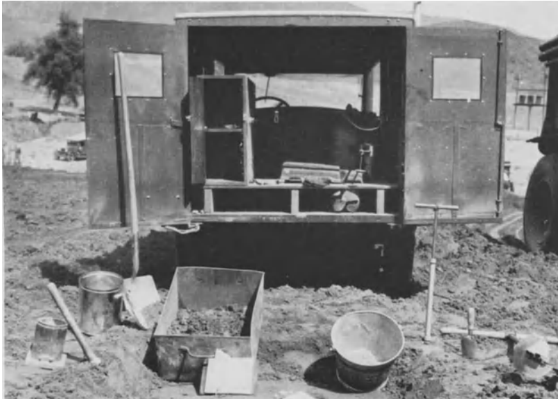
Abb. 329. Bodenuntersuchungswagen mit Geräten. (Lichtbild von Proctor, Los Angeles.)
