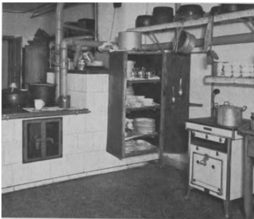
Abb. 144. Elektrischer Herd zur Ergänzung eines vorhandenen Kohleherdes in einem Landgasthof
