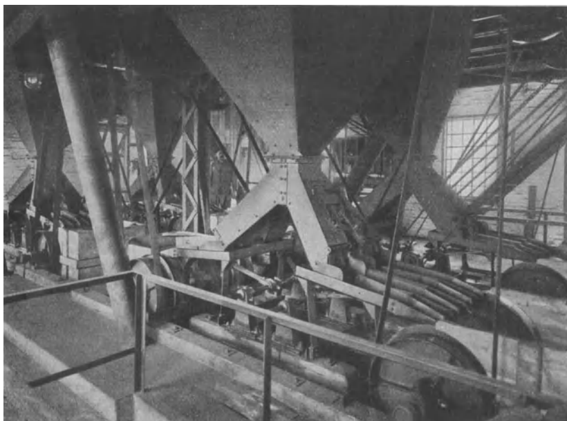
Abb. 6. Kruppsche Trommelscheider (Vierfeldtype) in einer größeren Schlackenseparationsanlage.
