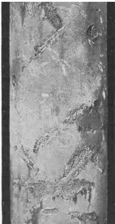
Abb. 216. Korrosion in Siederohren an Stellen mechanischer Beanspruchung (nach Körber und Pomp).
