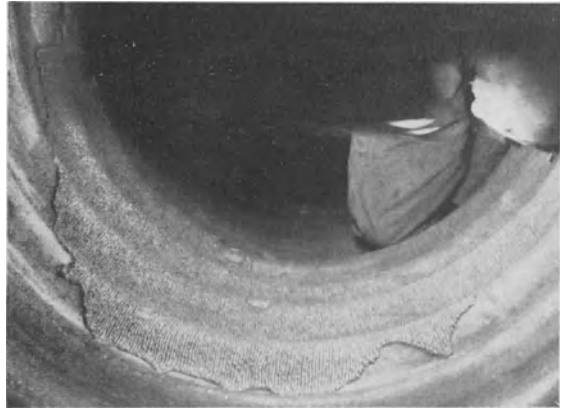
Abb. 238. Verschweißte Korrosionen an einem Kesselflamrohr.
