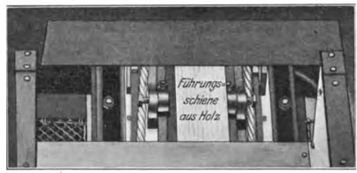
Abb. 16. Umführung der Seile an der Oberkante des Aufzuges. Die Seile wurden durch vorstehende Schraubenköpfe festgeklemmt.
