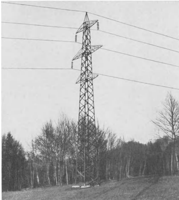
Abb. 106/2. Tragmast derselben Leitung wie Abb. 106/1, 250 m Spannweite (Motor A.G.).
