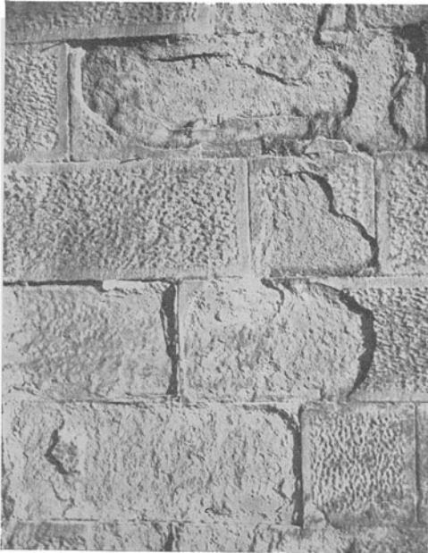
Abb. 201. Schalenförmige Abwitterung an Sandstein. Abb. 198 bis 201. Zerstörungsformen und -bereiche bei der Bausteinverwitterung.
