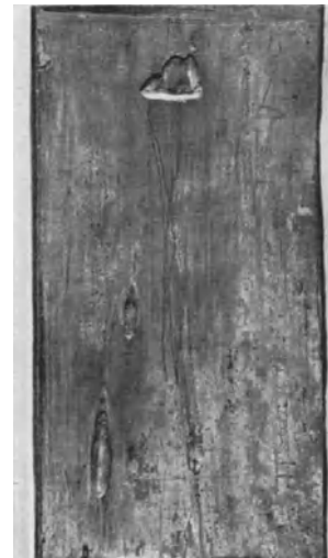
Abb. 21 (natürliche Größe). Dreieckförmige Korrosion an einem verzinneten Kondensatorrohr der Legierung 70/29/1, Brinellhärte 125 kg/mm 2 (s. S. 12).
