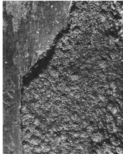
Abb. 56 ( V = 6 ). Messingrohrkorrosion mit den kraterförmigen Anfrassungen und daneben links die abgelagerte entzinkte glatte Kupferschicht (s. S. 32).
