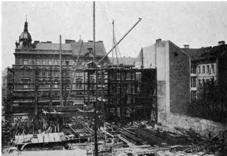
Abb. 324. Hochhaus Berg- und Hüttenwerks-Ges. in Prag. Ein Schwenkkran in der ursprünglichen Stellung, der andere bereits in seiner zweiten. Ein hölzerner Hilfsderrick für die Eckständer.
