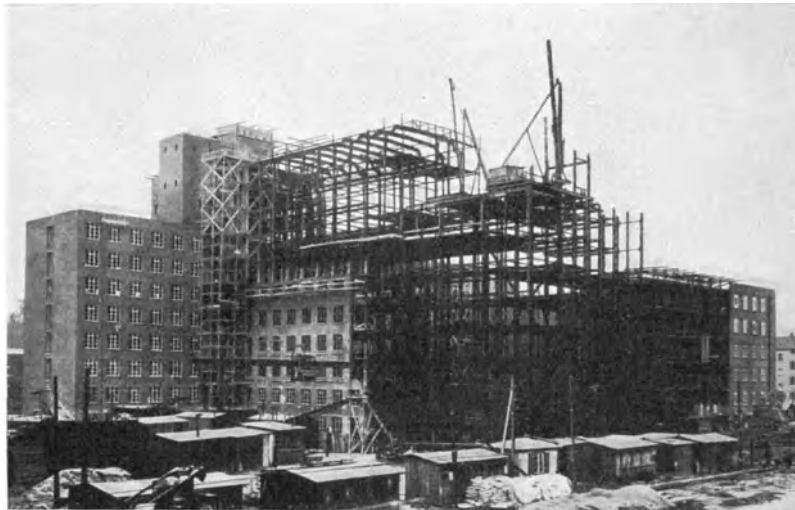
Abb. 333. Verwaltungsgebäude Wernerwerk X der Siemens-Halske A. G. und der Siemens-Schuckert-A. G. Berlin-Siemensstadt. Montagezustand. Ausführung: Vereinigte Stahlwerke A. G. Dortmunder Union.
