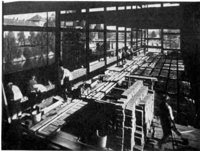
Abb. 336. Deutsches Museum in Munchen. Herstellung der Decken und Wände. Ausführung des Stahlskelettes: Vereinigte Stahlwerke A. G. Dortmunder Union.
