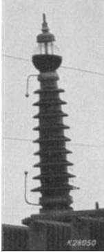
Abb. 61. Überbrückung der Isolation von Freiluftapparaten durch Funkenstrecken (Durchführung eines 110 kV-Transformators).
