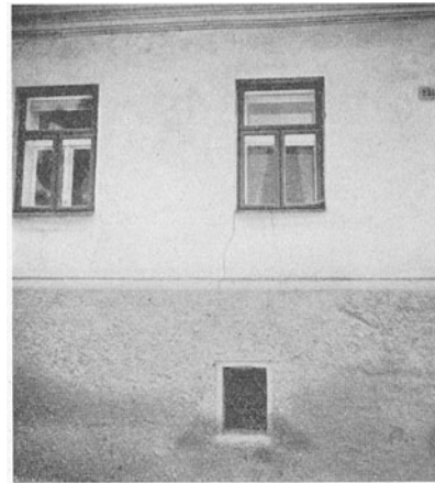
Abb. 6. Wigstadt. Risse durch Nachgeben des Fundamentes
