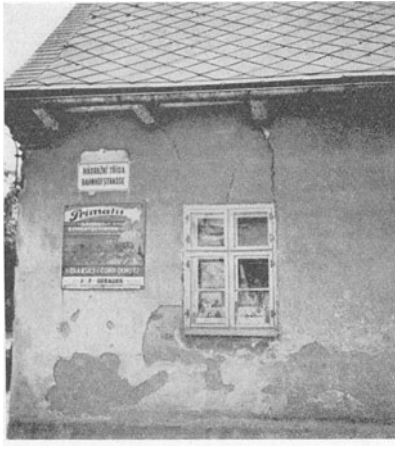
Abb. 5. Wigstadt. Risse über dem Fenster durch Nachgeben der Eckfundamente
