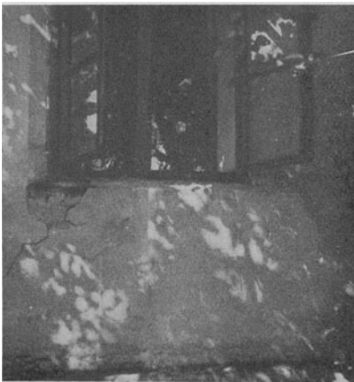
Abb. 11. Radwanitz. Risse unter dem Fenster
