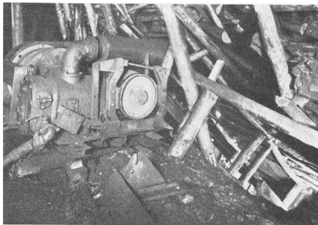
Abb. 9. Antriebsstation eines Bremsförderers
