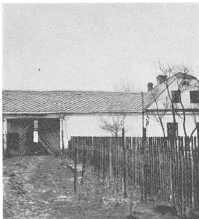
Abb. 7. Gerissene Hofmauer bei Wigstadt
