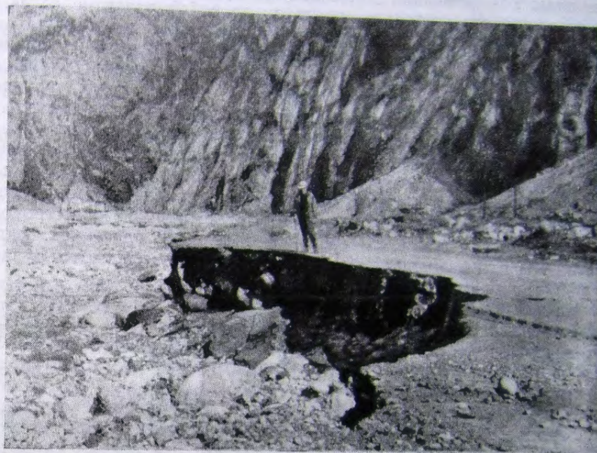
Рис. 32. Поврежденное селом полотно дороги
