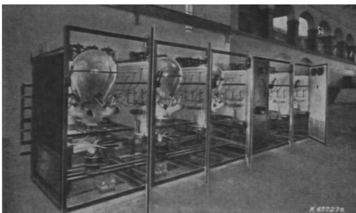
Bild 268. Ansicht einer im Betrieb befindlichen Glasgleichrichteranlage 5 \times 400 A mit Gitterregelung durch einen Drehregler (AEG.)
