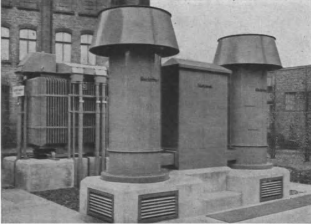
Bild 271. Eine Eisgleichrichteranlage mit pumpenlosen Gefäßen, ausgeführt als Freiluftstation 2 \times 500 A (J. Pintsch)
