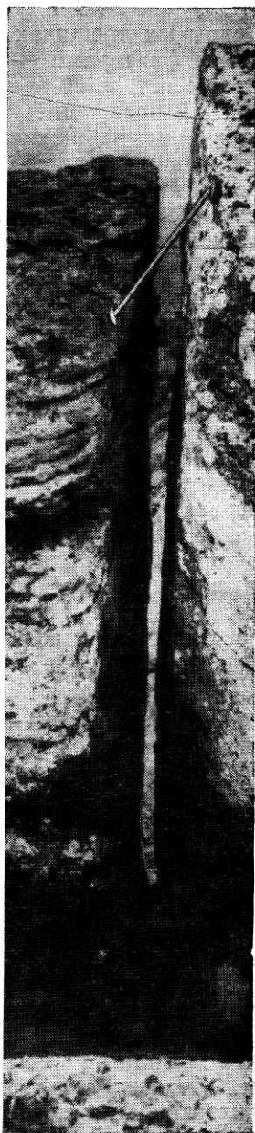
Рис. 17. Зияющая трещина на г. Демерджи (фото С. А. Брусилковского)
