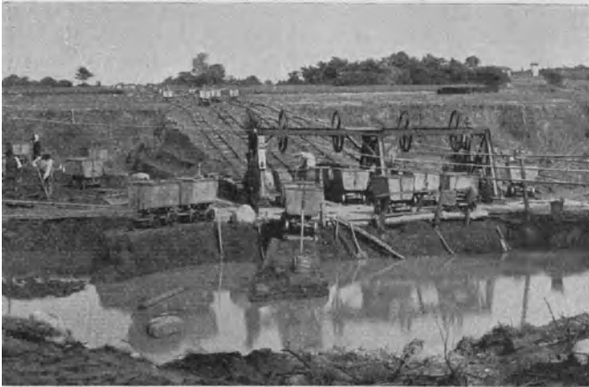
Abb. 309. Seilförderanlage für die Drahtseilbahn Itzehoe (Bleichert).
