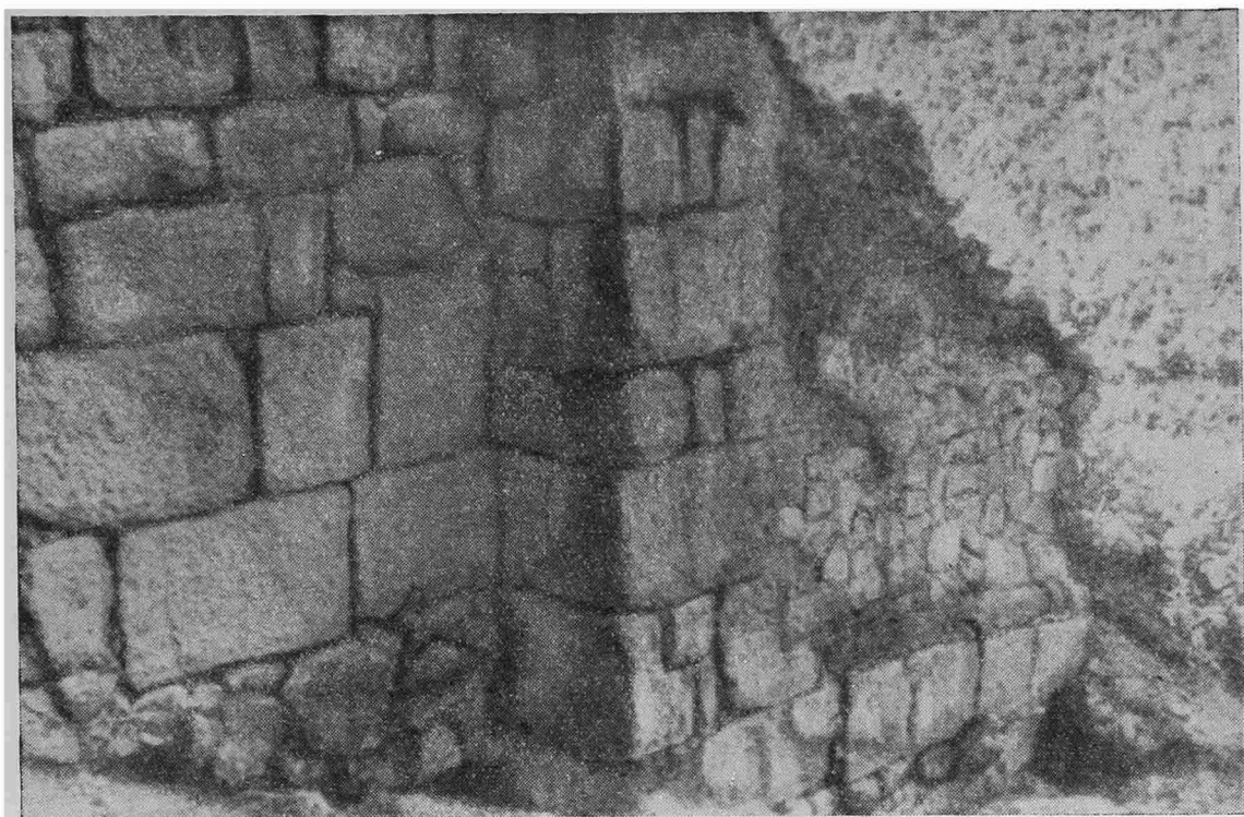
Рис. 6. Мангуп. Контрфорс в верхней куртине крепостной стены в Табана-Дере с прилегающими стенами. Справа видна надстройка XIV — XV вв.
