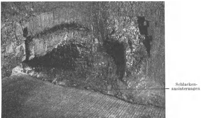
Abb. 41 u. 42. Schadhafte Feuergewölbe und ausgebrannte Seitenmauern des 500 m 2 Schrägröhrkessels in Abb. 44.
