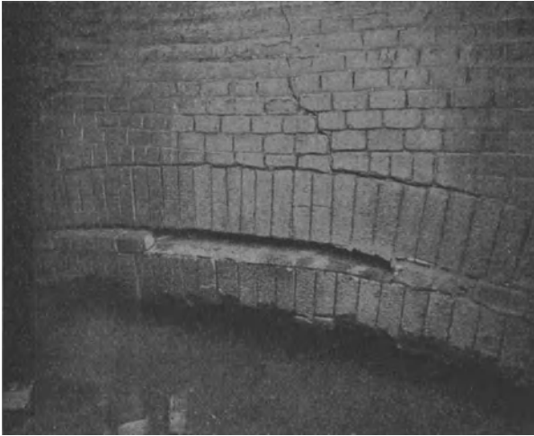
Abb. 29. Eingedrücktes Feuergewölbe mit abgebrannten Endsteinen.
