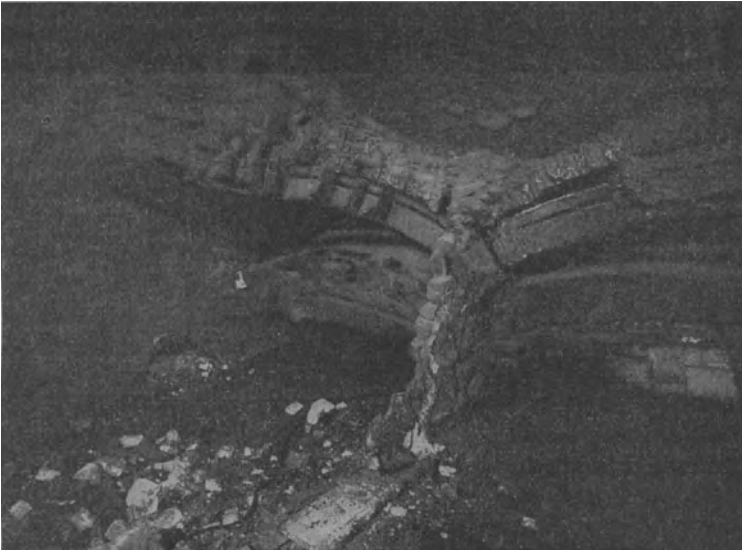
Abb. 28. Eingestürztes Feuergewölbe eines Steilrohrkessels.
