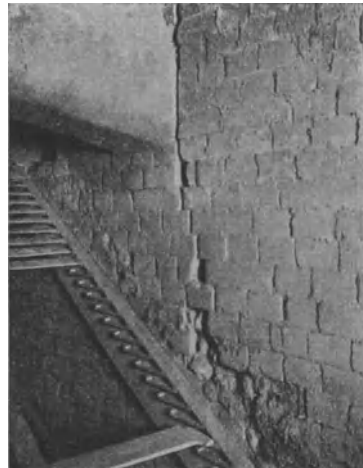
Abb. 45. Durchgerissene Wange zwischen den Rosten einer Treppengrostfeuerung für Braunkohle.
