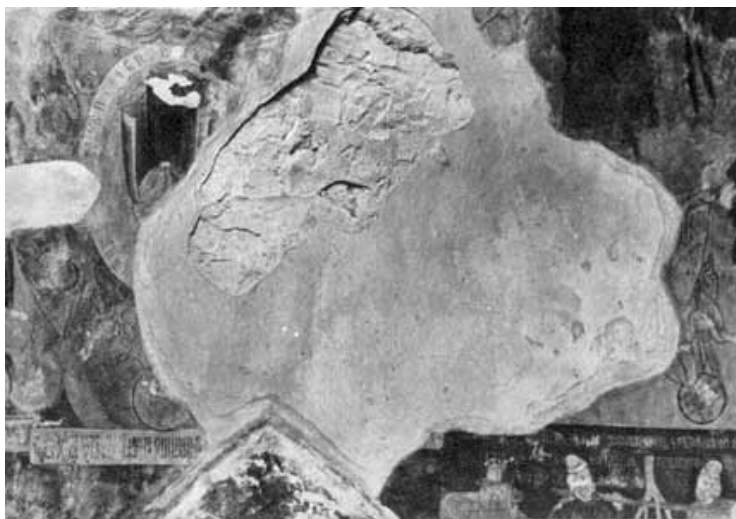
Фото 42. Выпад штукатурки на коробовом своде.
