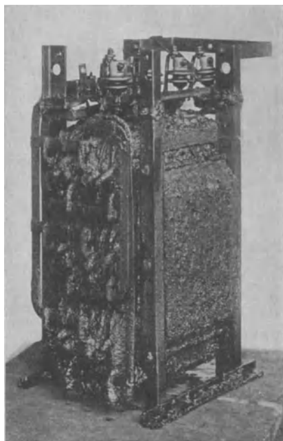
Abb. 2. Verschlammter Transformator (nach Aufnahme von Dr. E. Stern, AEG).
