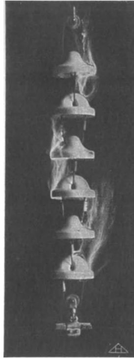
Abb. 57. Lichtbogenüberschlag an einer Schlingenisolatorenkette bei Regen.
