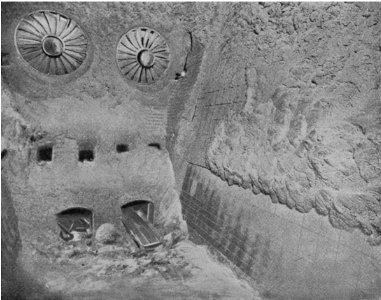
Abb. 231. Schaum- und flugsandartige Ansätze an Stirn- und Seitenwand einer Bailey-Dampfkesselbrennkammer; beachte die Schleudervirkung der Drallbrenner.
