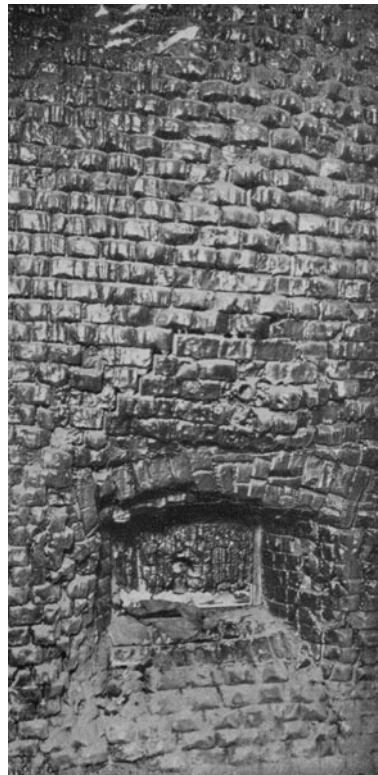
Abb. 109. Kuppenartige Auszehrung der Stirnwand einer Dampfkesselbrennkammer.
