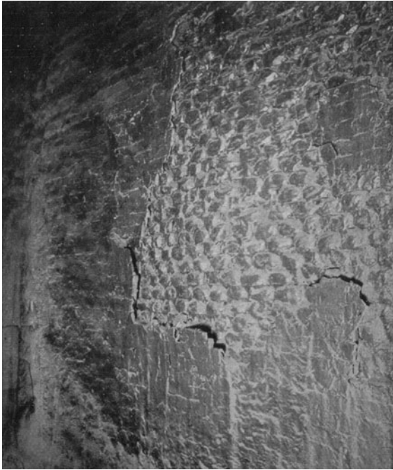
Abb. 108. Schadhafte Brennkammer-Rückwand eines Dampfkessels 1) .
