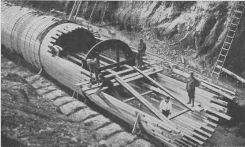
Abb. 485. Holzrohr von 4 m Durchmesser eines Zweigwerkes der Niagarafälle, E.W.
