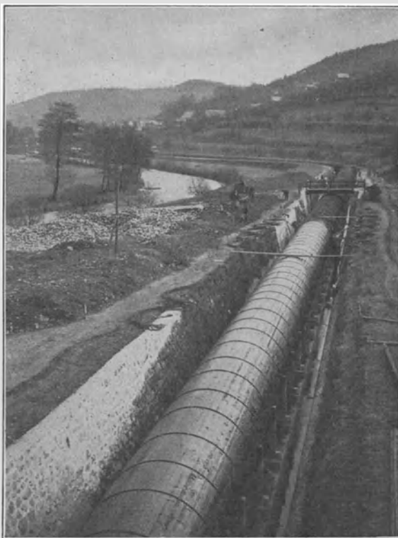
Abb. 486. Turbinendruckwasserleitung, 2,75 m Durchmesser, der Papierfabrik Grohmann in Klein Wöhlen bei Bodenbach. (Hergestellt von der Deutschen Holzröhren A.-G., Hannover, „Deuhrag“).
