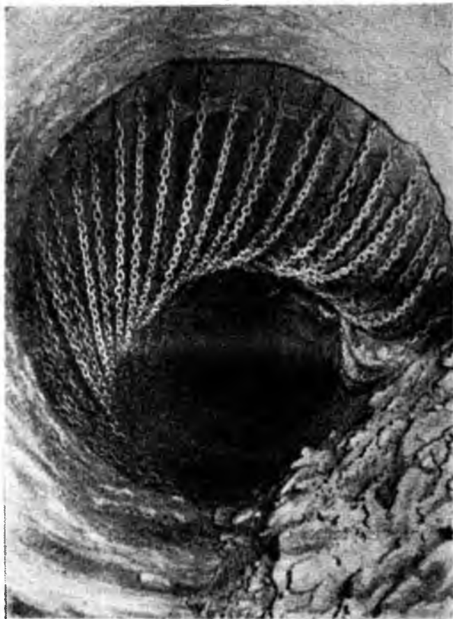
Рис. 3. Гирляндная цепная завеса (цементный завод «Октябрь»)
