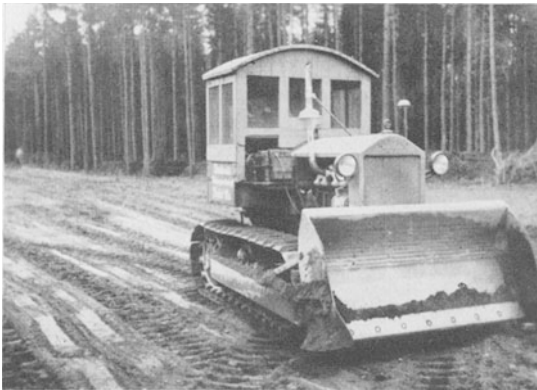
Abb. 51. Der Bodenverteiler (Planieraube) von MENCK & HAMBROCK befördert Sand aus einem Einschnitt und verdichtet gleichzeitig den Untergrund. Diese Aufnahme läßt deutlich die tiefen Druckspuren erkennen.
