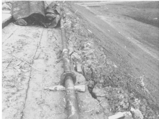
Abb. 164. Undichte Rohrleitung für Deckenarbeiten führt zur Auflockerung der Dammschulter.
