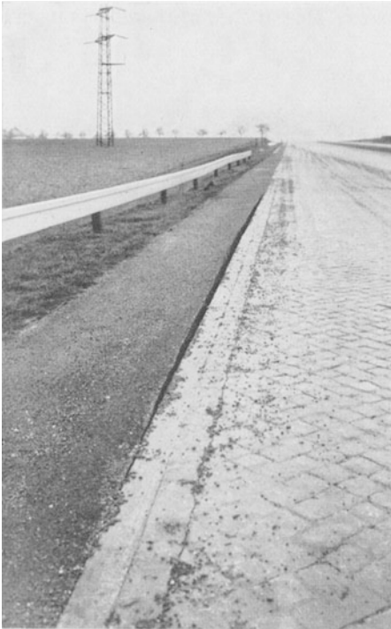
Abb. 132. Unvermeidliche Setzungen und Schäden an der Decke bei dieser Brücke.
