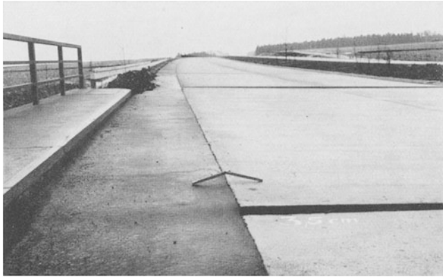
Abb. 160. Frosthebungen an einem Widerlager (Decke liegt auf 5–6 m hohem Damm).
