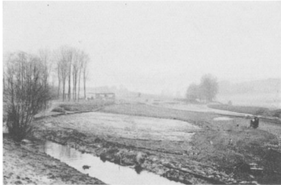
Abb. 122. Schüttung einer Gesteinsschicht am Dammfuß als Sicherung gegen Rutschgefahr bei aufgeweichtem Boden.
