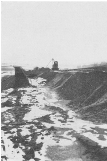
Abb. 159. Unzweckmäßige Verfüllung eines Widerlagers.
