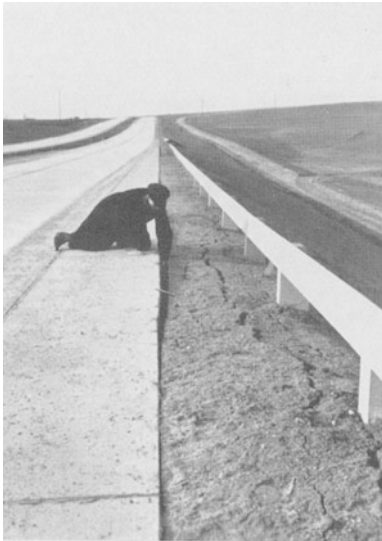
Abb. 161. Dammschultersetzung. Die Dammschultern lösen sich unter Reißbildung von der Decke.
