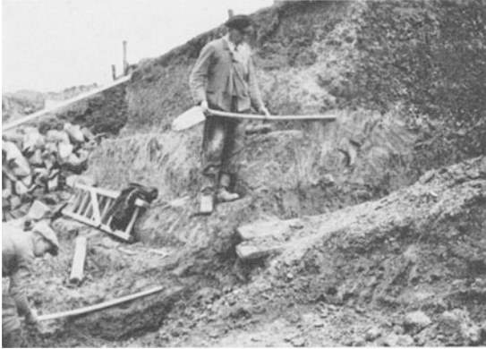
Abb. 171. Aufschlitzen des Hanges zur Beseitigung der Rutschgefahr. Der Mann zeigt auf die Rutschschicht.
