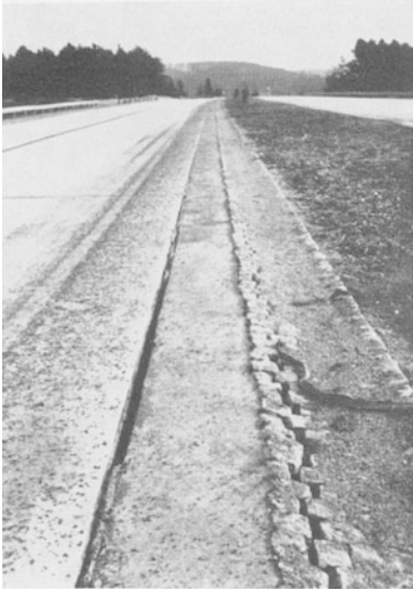
Abb. 163. Die Dammitte wird von den Schäden der Dammschulteretzungen in Mitleidenschaft gezogen.
