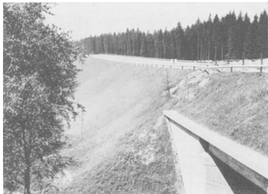
Abb. 165. Dammschultersetzung und Auswaschung an der Überschüttung von Bauwerken.
