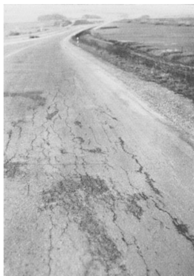
Abb. 158. Schäden an der Decke infolge verschleppter Setzungen. Die Schwarzdecke zeigt Risse in Nähe der Dammschultern
