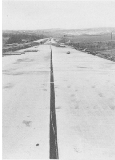
Abb. 162. Fortschreitender Dammschaden führt zur Öffnung der Fugen an der Betondecke.
