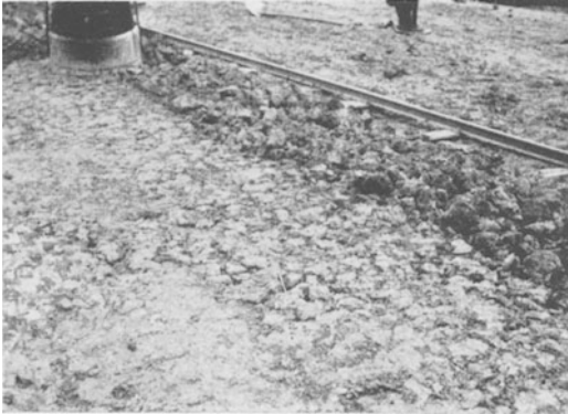
Abb. 124. Löcherige Oberfläche infolge ungenügender Verdichtung.
