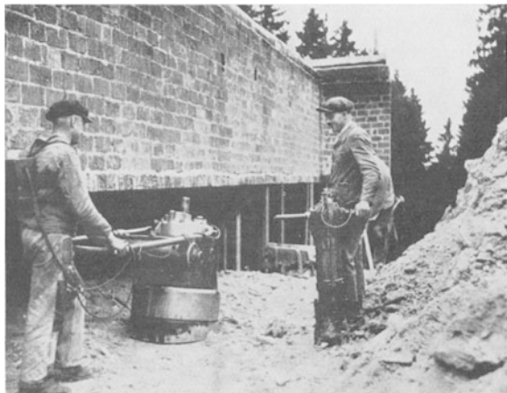
Abb. 109. Frosch und kleine Delmagrammen bei der Verdichtung eines Kastenwiderlagers (aufgelöstes Widerlager) (Aufn. Dr. SCHULZ).
