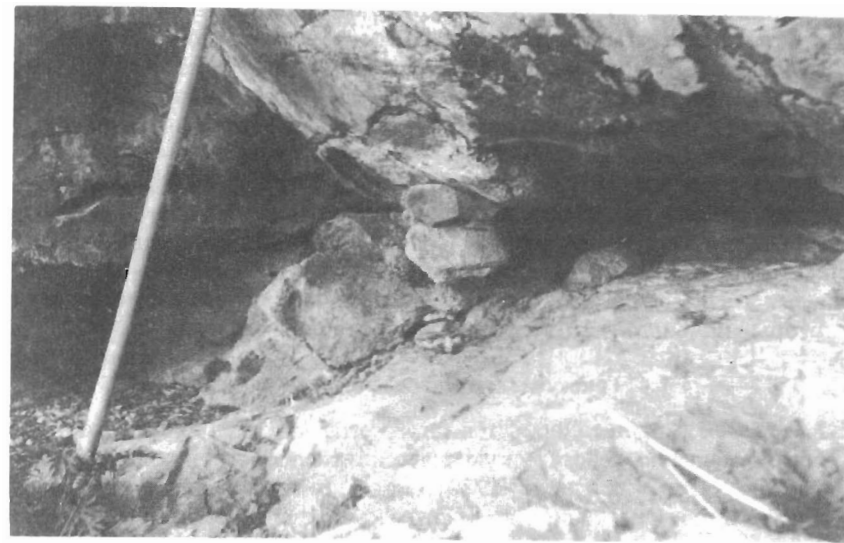
Р и с. 9. Зияющие трещины в гранодиорите, образованные при суффозионном выносе выветрелого тектонита (МНР, строительная площадка ГОКа Эрденет), фото М.И. Погрёбского
