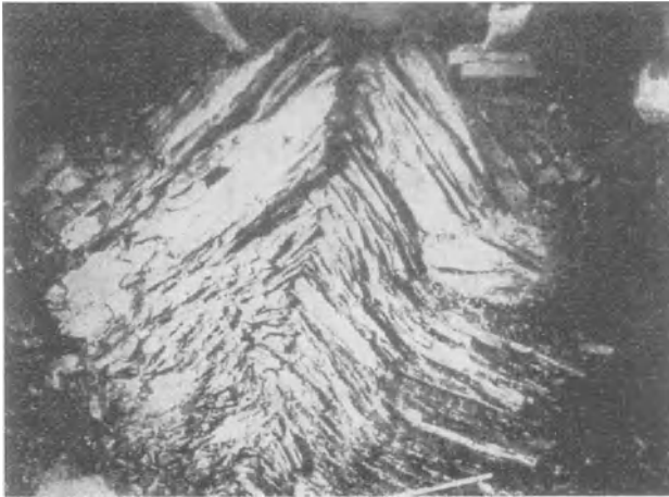
Abb. 19. Ausquetschen der Sohle im Simplontunnel km 6,740 ab S. P. (nach Andreae).
