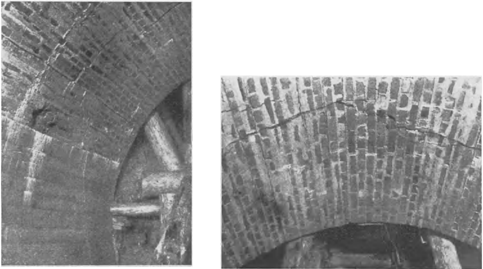
Abb. 51. Eine ursprünglich unversehrt gebliebene Mauerungszone wird durch die Ausbruchsarbeiten in der Nachbarschaft zerstört. Die Gefügauflockerungsbewegungen reißen von dem Ring eine Scheibe ab (nach Heilbrunner).
