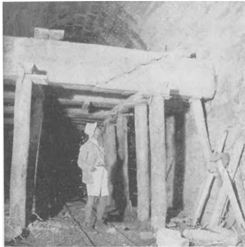
Abb. 39. Zerdrückte Betonstrebe im Tunnel 16 der Elburs-Nordrampe (nach Rabcewicz).
