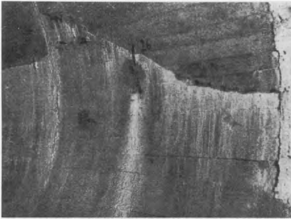
Abb. 50. Risse an den Ulmen an der standfesteren Glimmerschieferzone (nach Heilbrunner)
