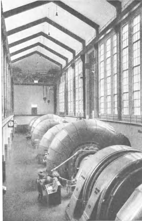
Abb. 359. Blick in den Maschinenraum des Bleiloch-Pumpspeicherkraftwerkes.
