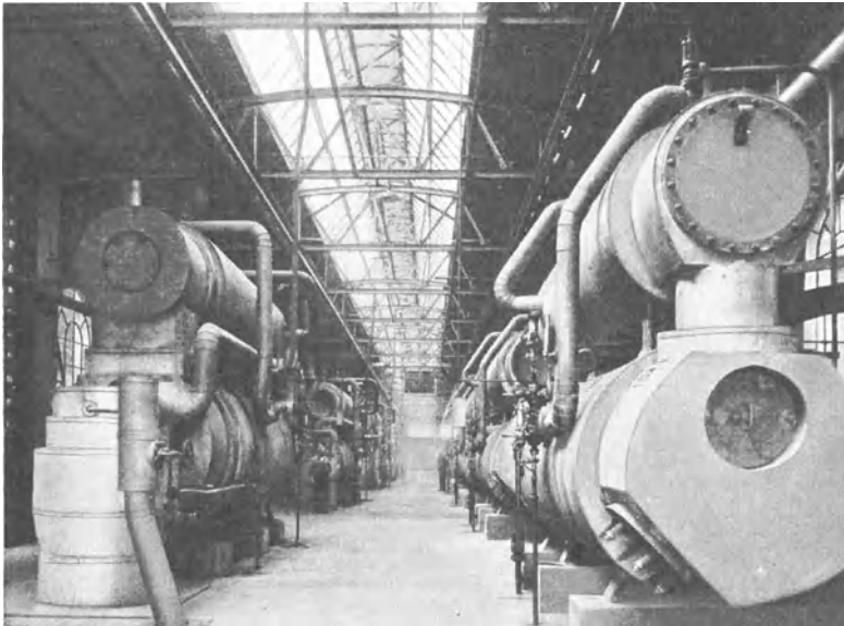
Abb. 307. MAN-Abwärmeverwerteranlage mit Abwärmedampfkessel, Überhitzer und Speisewasservorwärmer, 14 ata, 350° C. 10 Gasmotoren.
