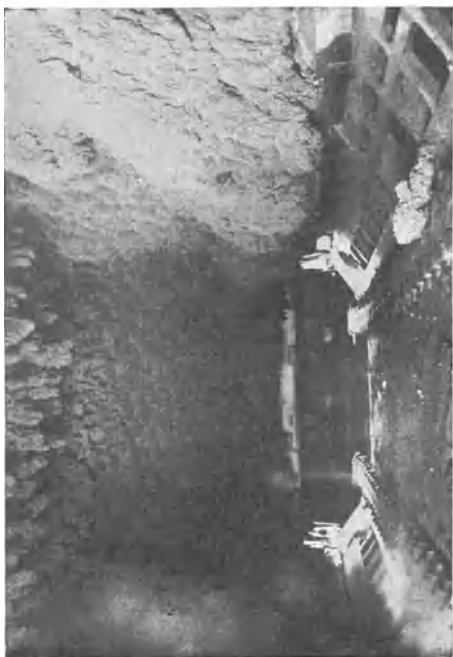
Vor Anwendung des La-Mont-Verfahrens. Abb. 135. Ansinterungen an den Feuerraumwänden eines Steilrohrkessels.
