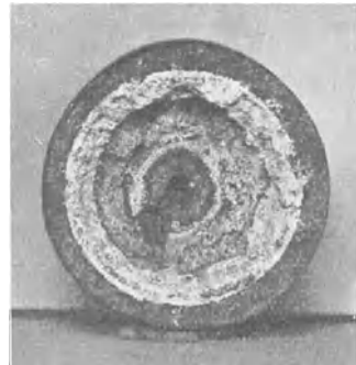
Abb. 100. Durch Kesselstein vollständig zugesetztes Speisewasservorwärmerrohr.
