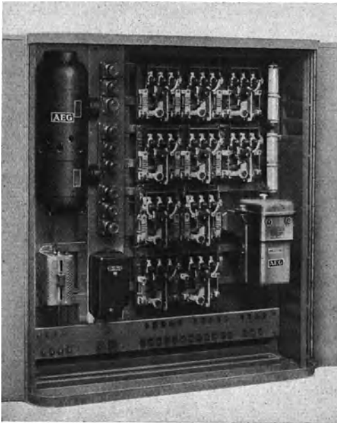
Abb. 76. Schaltschrank eines Bohrwerkes. Der Einachsbrumumformer links oben liefert durch sein Schwungmoment auch beim Ausbleiben der Netzspannung ausreichend Bremsgleichstrom.
