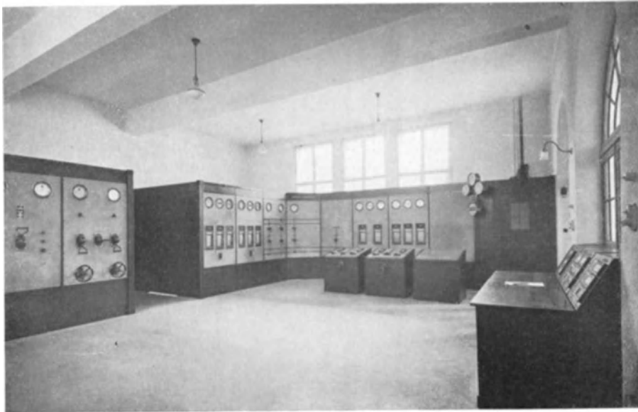
Bild 39. Betätigungsraum, Umspannwerk Nürnberg.
