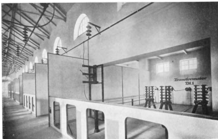
Bild 38. Drosselspulenraum, Umspannwerk Nürnberg.
