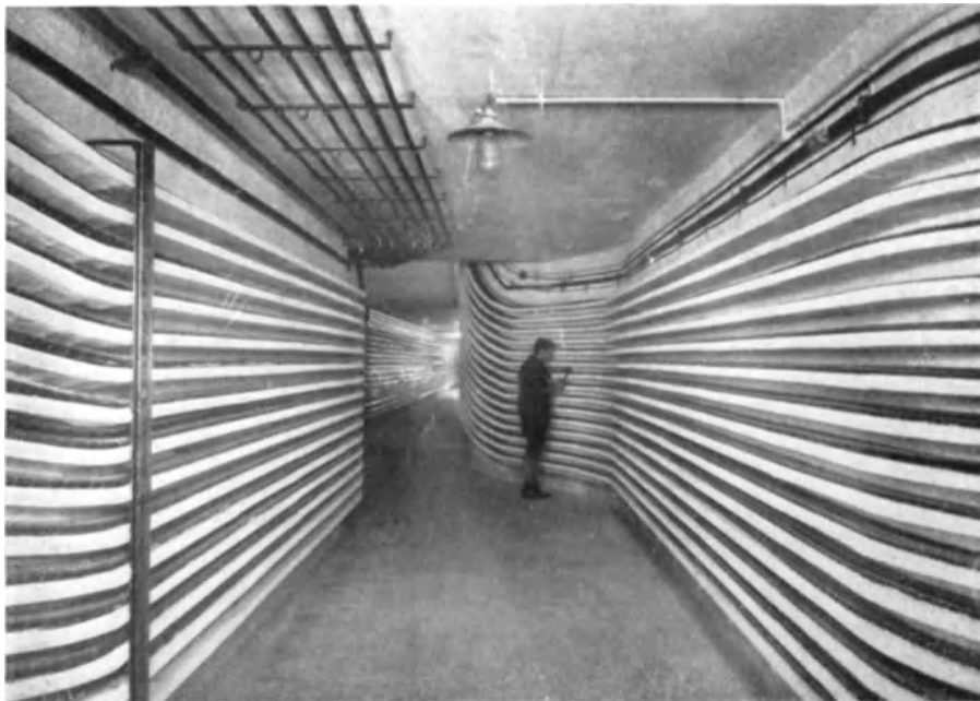
Bild 97. Blick in den Kabelkanal. (In den Nischen liegen die Betätigungskabel.)
