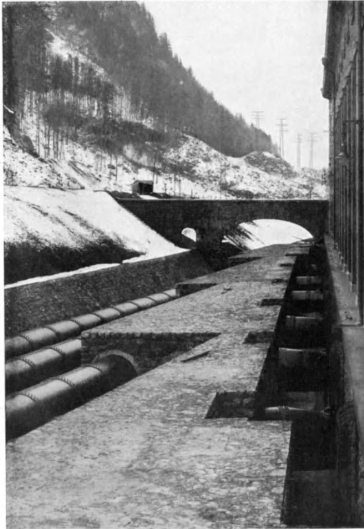
Bild 77. Letzter Festpunkt der Rohrbahn vor dem Krafthaus.
