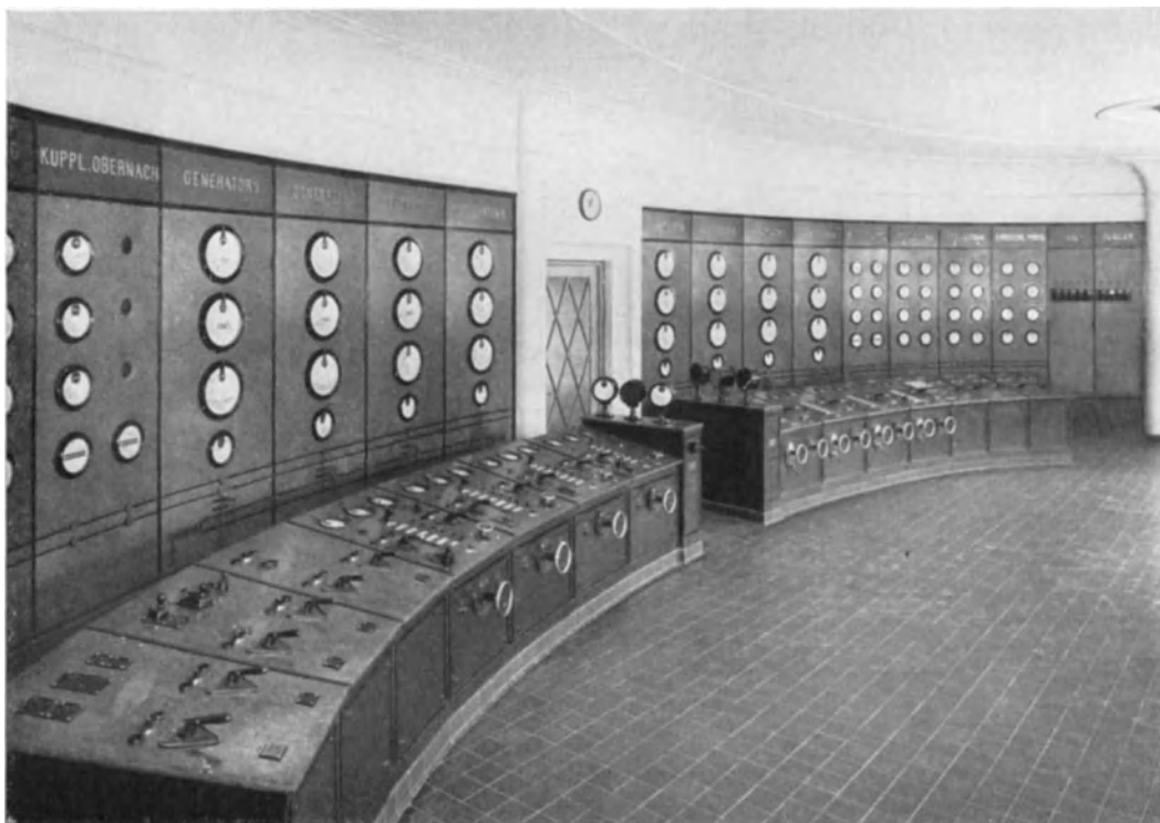
Bild 101. Kommandostelle Walchenseewerk (Innenansicht).
