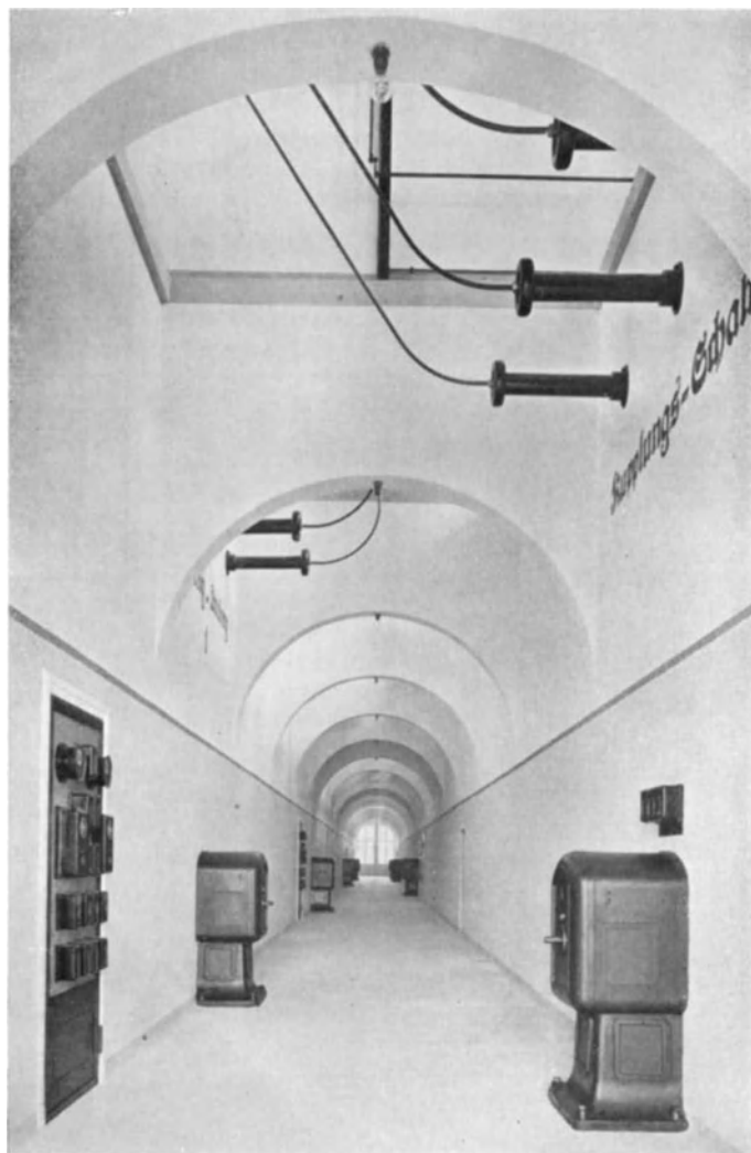
Bild 40. Bedienungsgang im 100 kV-Schaltheus des Umspannwerkes Nürnberg.
