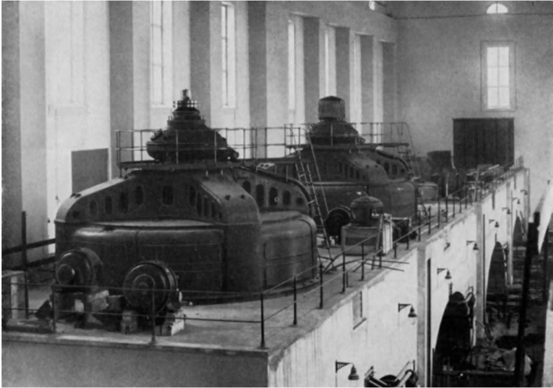
Bild 116. Generatorenpodium im Kraftwerk Aufkirchen. (2 Aggregate für Dreh-, 2 für Einphasenstrom.) Die 2 Drehstromaggregate sind bereits montiert. In den 4 Gewölben unter dem Podium befinden sich die Francis-Spiralturbinen.
