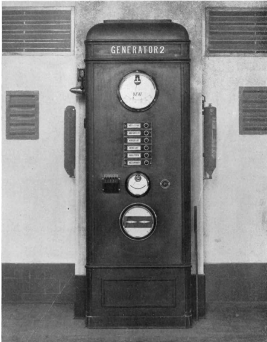
Bild 102. Instrumententafel an den Pfeilern der Maschinenhalle. Seitlich der Tafel sind die durch Jalousien verschließbaren Ansaugöffnungen für die Generatorkühl'uft bei Entnahme aus dem Maschinenhaus angeordnet.
