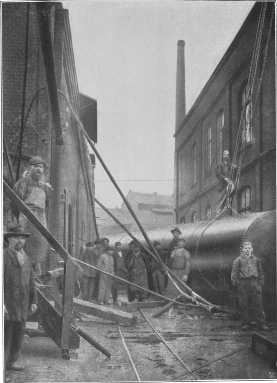
Mittels „Thermit“ geschweißte Rohre, die durch einen umgestürzten Kessel herabgerissen und verbogen wurden, ohne leck zu werden
