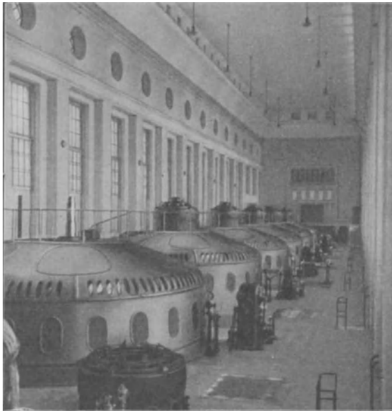
Abb. 182. Kraftwerk Eglisau. Kurz vor Fertigstellung. Hinten an der Decke drei Warmluftaustrittsöffnungen („A“ der Abb. 183).
