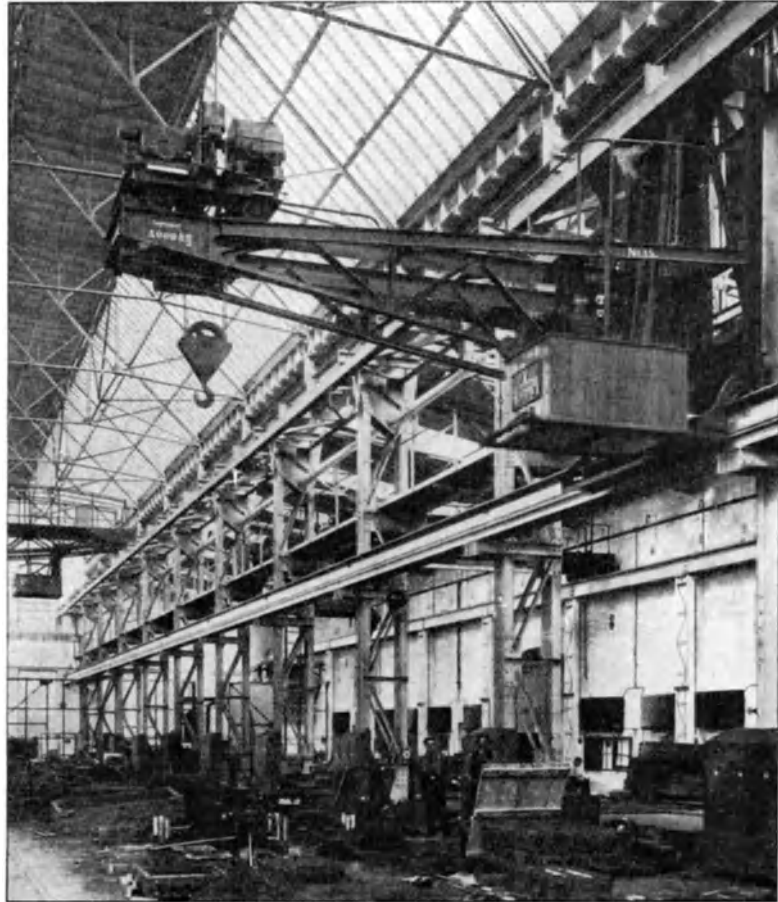
Abb. 523. Krananlage in einer Eisengießerei (Buckau).
