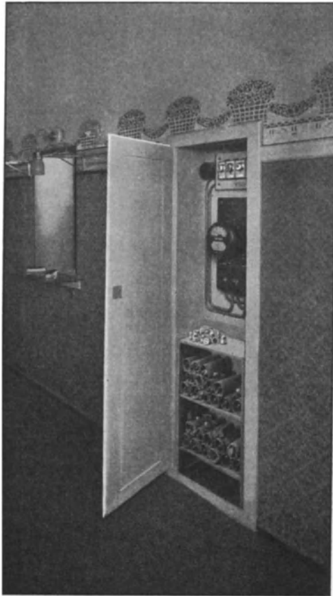
Fig. 14. Wandschrank mit Verteilungsstelle im Korridor einer Wohnung.
