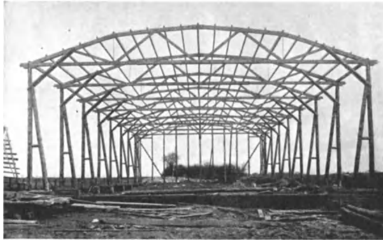
Abb. 231. Scheune auf Gut Hoebeck ohne Dacheindeckung und Verschalung.
