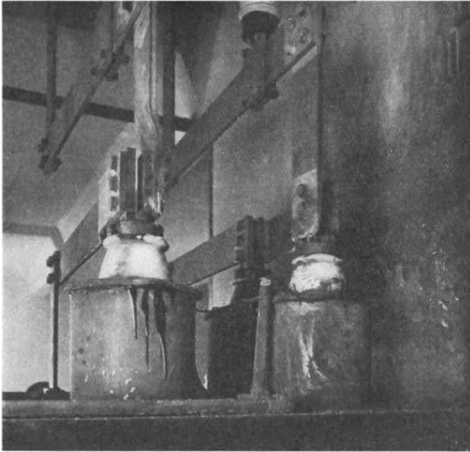
Abb. 252. Kurzschlußwirkung an Stromwandlerdurchführungen.
