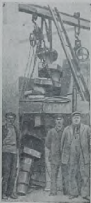
Рис. 269. Заварка трещины в месте перехода шейки вала в щеку второго кривошипа теплохода „Красноармеец“.
