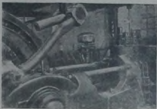
Рис. 344. Вид газовой машины после аварии.
