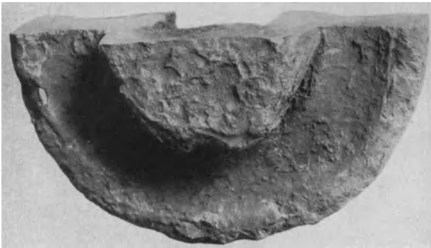
Abb. 57. Korrosion eines Ekonomiser-Verschußdeckels.
