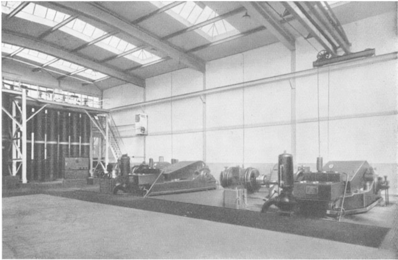
Abb. 48. Kraftwasseranlage mit einem 3000 l-Druckluftakkumulator und zwei horizontalen Pumpen für eine Gesamtleistung von etwa 1000 PS. (Hydraulik G. m. b. H., Duisburg.)
